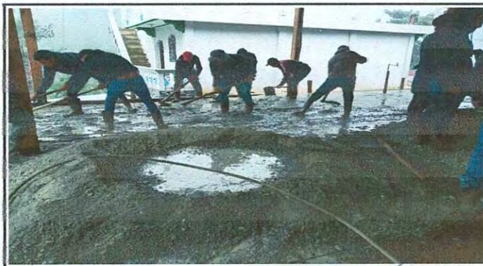
Foto 4: Susticion de plancha de concreto de patio
